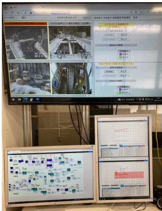
水道施設中央監視システム（東俣浄水場内）
